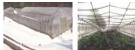
市内ビニールハウスの被災状況(例)
