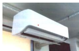
民間事業所のエアコン設置
